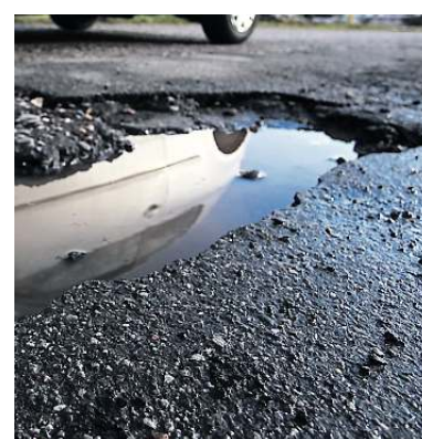
Schlaglöcher und Fahrbahnrisse machen die Sanierung der L 596 zwischen Ursenbach und Rippenweier unumgänglich.
